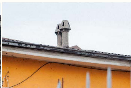
Detalle de chimenea de población Choferes. Foto Loreto Vergara. Archivo Corporación de Cultura y Patrimonio de Independencia.
